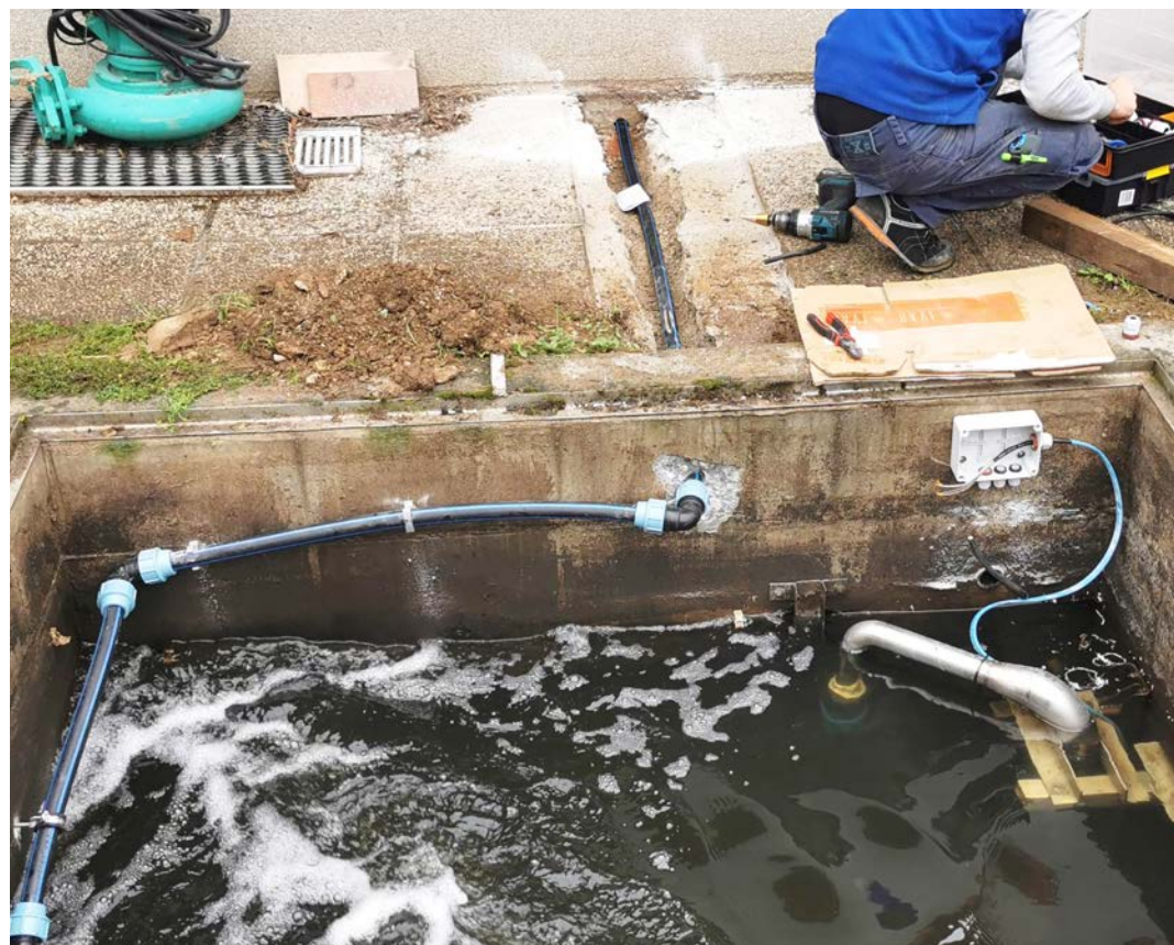
Slika 2: prostor za tehnološko vodo
